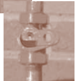
Medidor de gas cerrado
