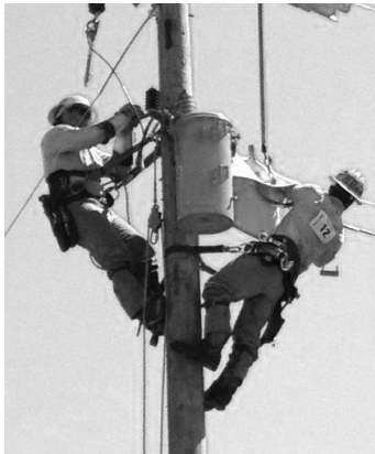
Huston y Smith compiten en una prueba de transformador averiado
